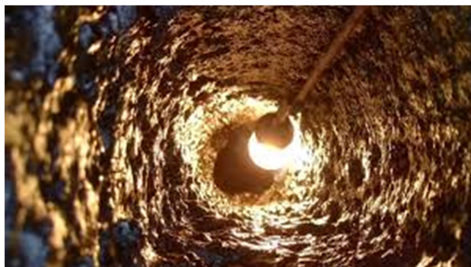
Rys. 4. Widok wnętrza przewodu dymowego pokrytego sadzą.
